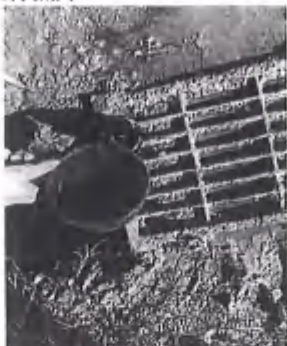
生活污水排放口
