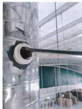
印刷、粘合工序废气排放口
