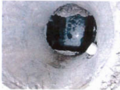
生活污水排放口
