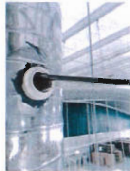
印刷、粘合工序废气排放口
