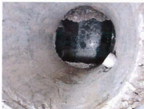
生活污水排放口
