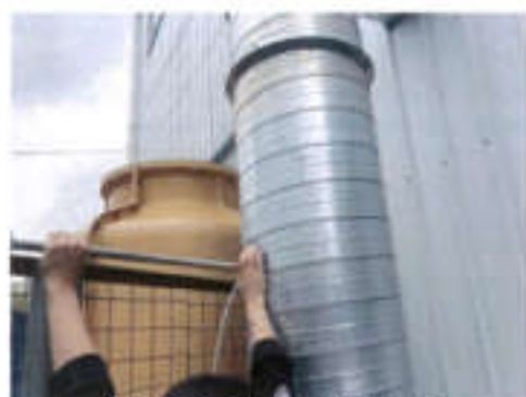
印刷工序废气处理前采样口
