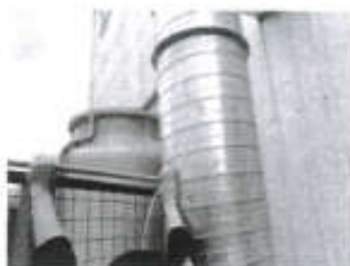
印刷工序废气处理前采样口
