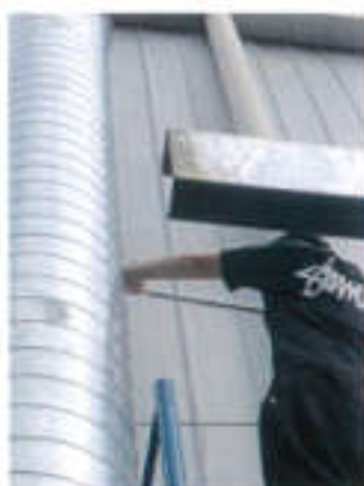
印刷工序废气处理后排放口
