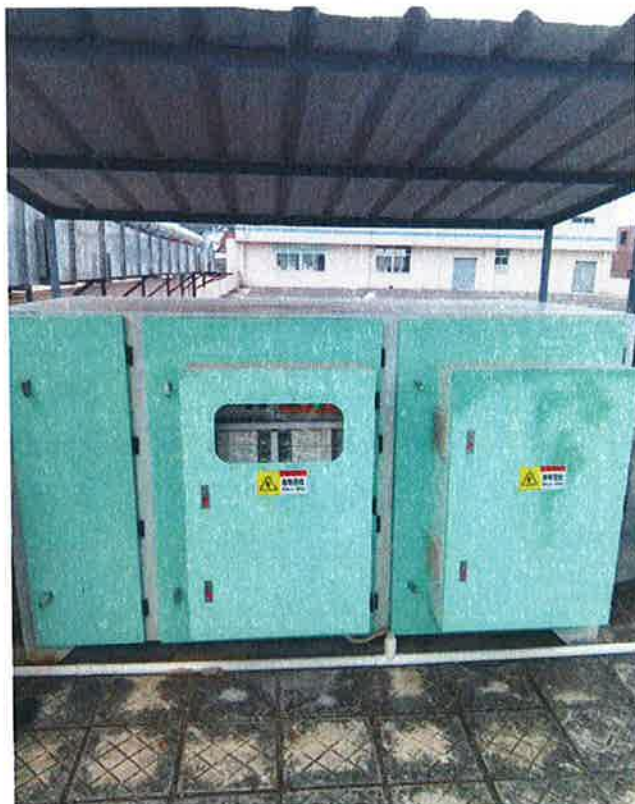
废气处理设施
