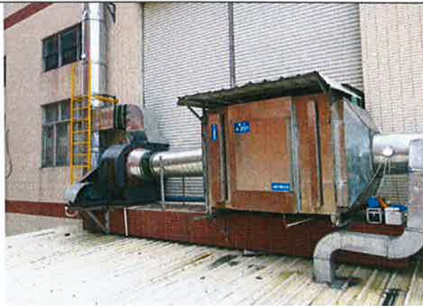
废气处理设施
