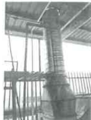
注塑废气处理后排放口 04#
