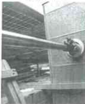
喷粉废气处理后排放口 1# 05#
