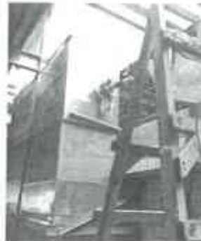
喷粉废气处理后排放口 2# 06#
