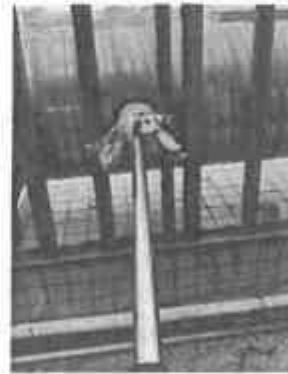
喷粉固化、天然气燃烧尾气废气处理前采样口○1#
