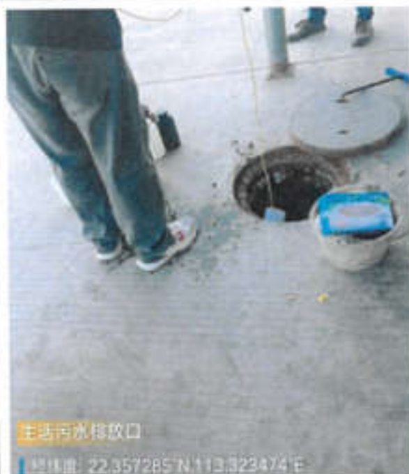
生活污水出水口
