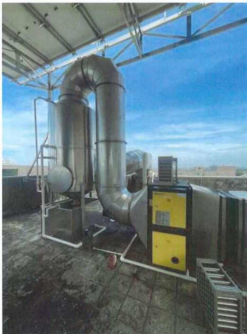
附图 3：废气治理设施图片
