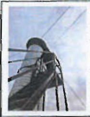
喷漆、烘干工序废气 G2 排放口
