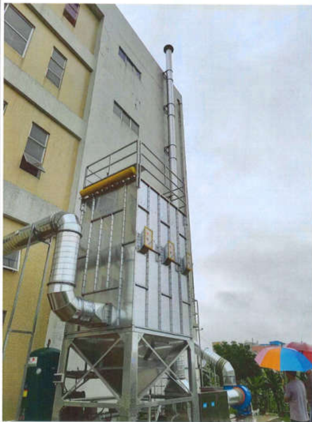
附图 3：废气治理设施图片
