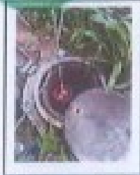
生活污水排放口
